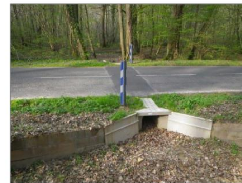
Exemple de passage à petite faune sous voirie ©Biotope
