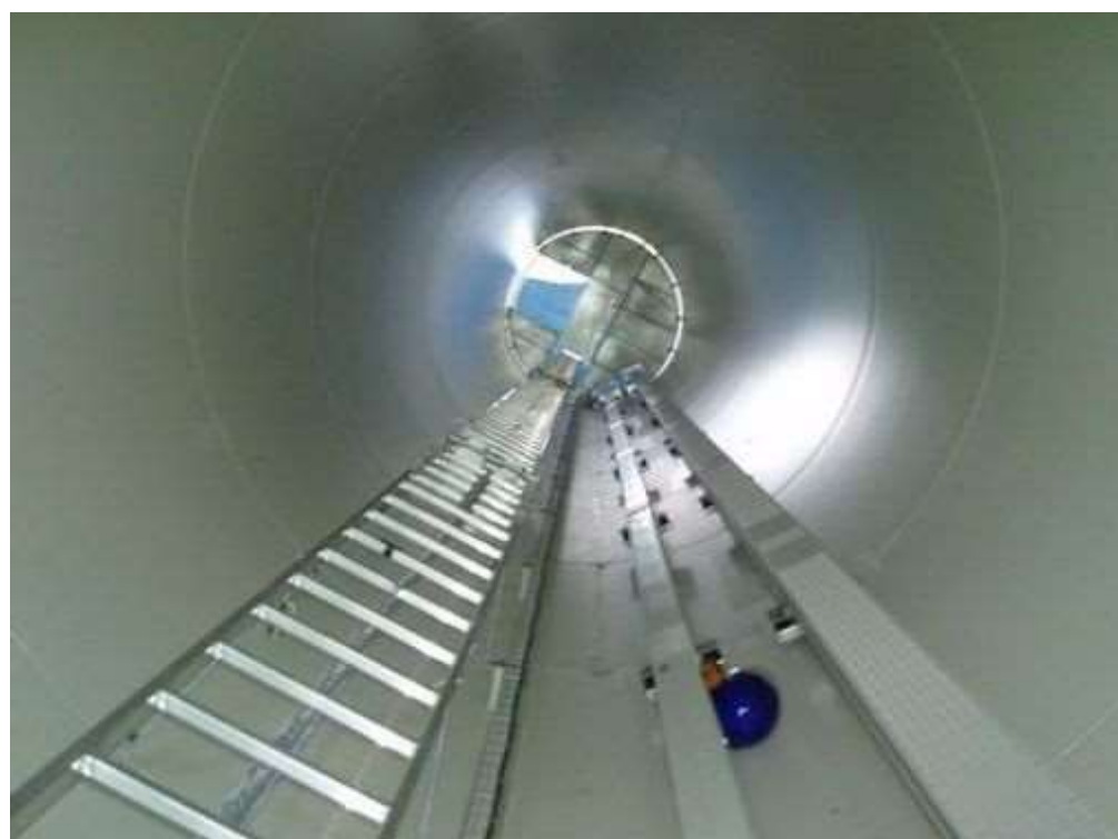
Photo 1 : Intérieur d'un mât équipé
