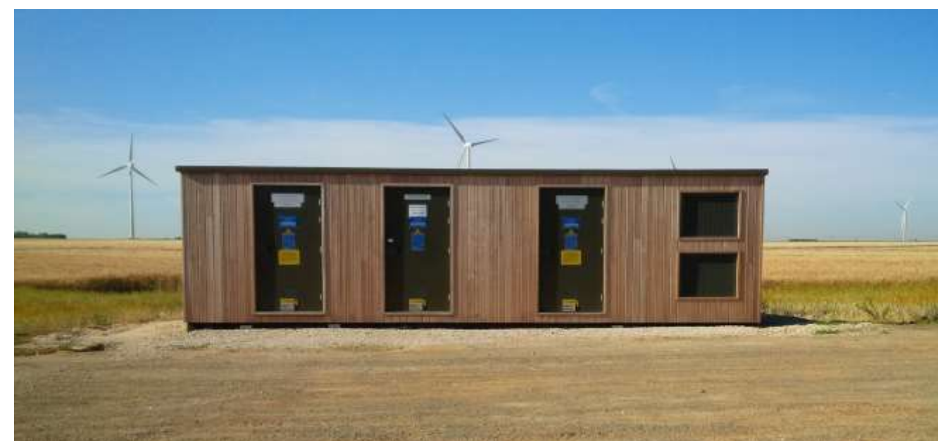
Photo 2 : Exemple d'un poste de livraison
