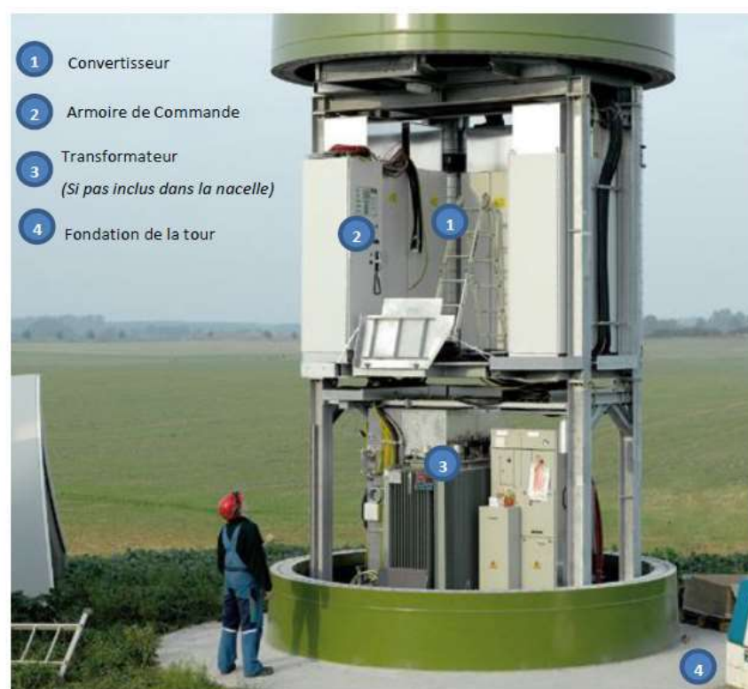
Illustration 1 : Transformateur inséré dans le mât (Enercon)
